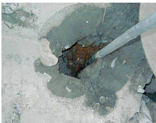
Bild 8: Bei der Perforation entstandene Wegsamkeit bis GOK
